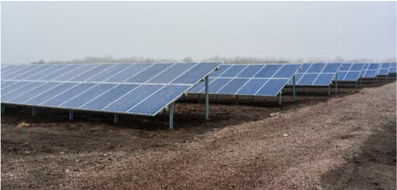
Esimerkkikuva aurinkopaneeleista (Vapo Terra).
