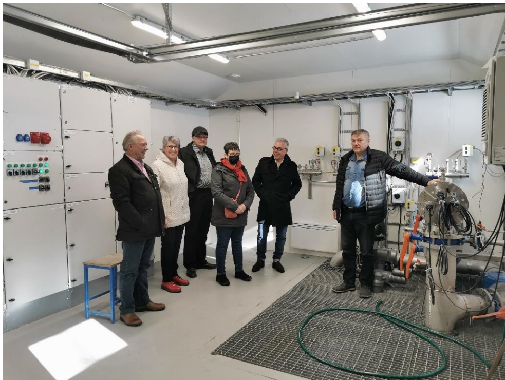
Tarkastuslautakunnan tutustumiskäynti Kauhajoen Vesihuolto Oy:hyn / Siniharjun pumpaamoon.
